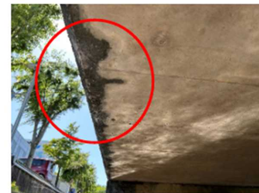
(b) 床版橋端部の伝い水
