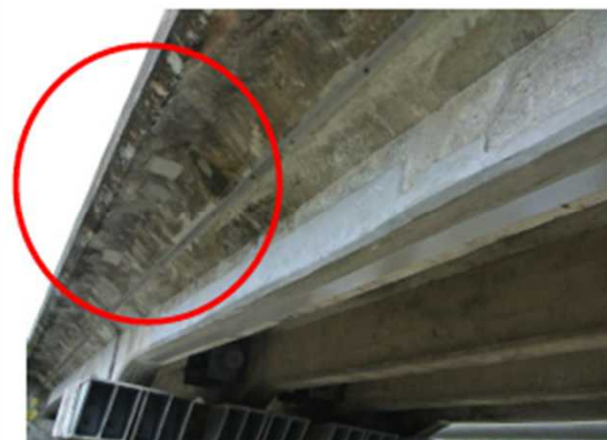
(a) RC 床版張出し部の伝い水
